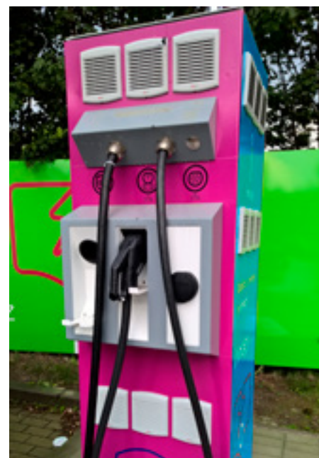
Nabíjecí stanice Innogy.
