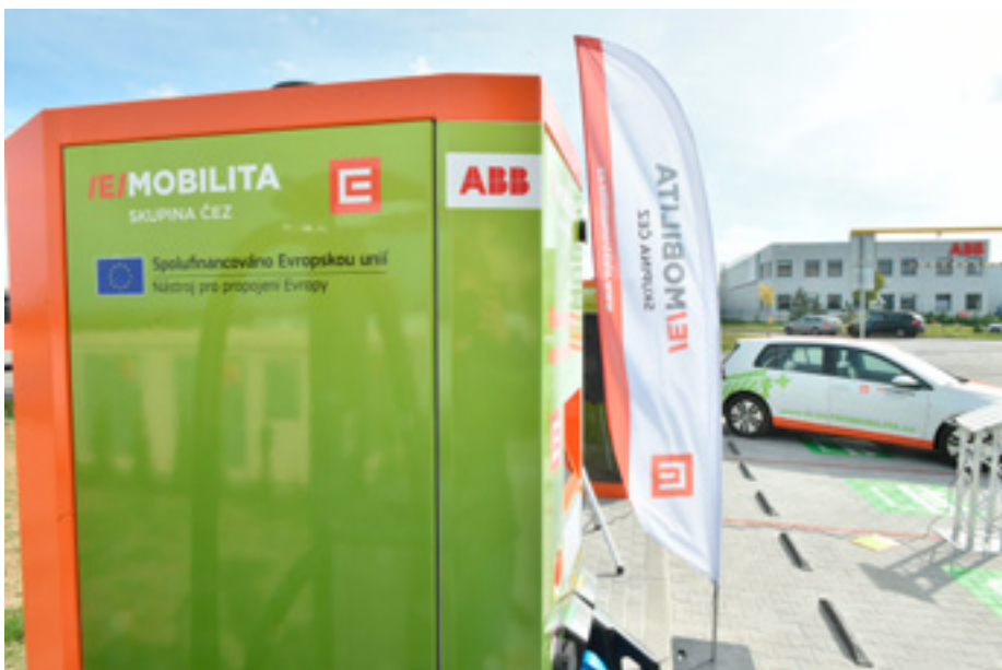
Nabíjecí stanice ABB od ČEZ ve Vestci u Prahy.
