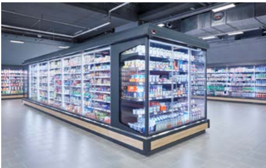
Z hlediska úspornosti jsou výhodnější chlazené regály s prosklenými dveřmi
