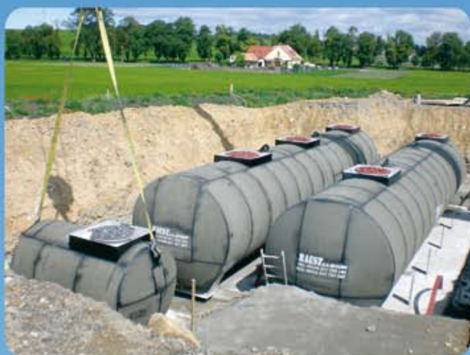
SKLADOVACÍ NÁDRŽE 2x80m 3 ; 1x5m 3
